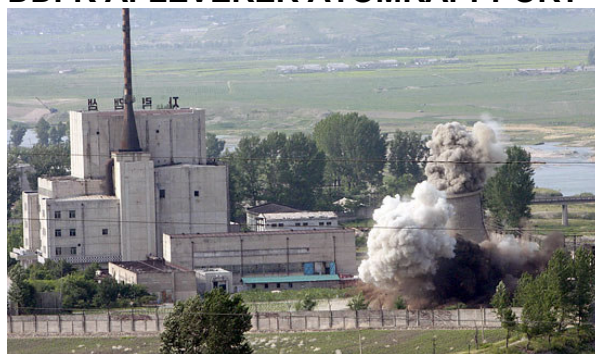
Sprængning af køletårnet i Nyongbyon Atomanlægget den 27. juli 2008 ca. 100 km nord for hovedstaden.
